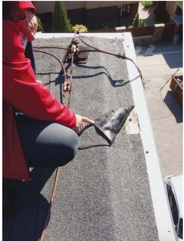
Obr. 8 Plochá strecha v Košiciach – ďalšia strecha po rekonštrukcii s množstvom nedostatkov, ktoré vedú k poruchám. V súčasnej dobe je v štádiu odborného posúdenia.
