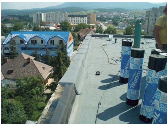
Obr. 3 Bytový dom Snina – po kompletnej demontáži nefunkčnej hydroizolácie a spádovej vrstvy firma IZOLA Košice zrealizovala nové prespádovanie penobetónom a novú hydroizoláciu z modifikovaných asfaltových pásov – dvojvrstvový systém
