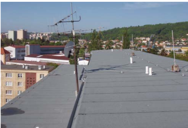
Obr. 7 Stav plochej strechy po opätovnej rekonštrukcii (zateplenie minerálne dosky Nobasil DDP hr. 100 mm, hydroizolácia – modifikované asfaltové pásy v dvoch vrstvách, mechanicky kotvený systém)
