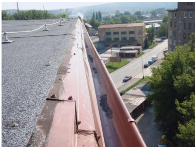
Obr. 4 Bytový dom Košice – stav strechy po realizácii rekonštrukcie plochej strechy so zateplením. Nevhodné riešenie oplechovania okraja strechy lakoplastovaným plechom. Vlastníci si vybrali na základe odporúčenia jedného z vlastníkov – mám známeho a ten má firmu, čo urobí všetko. Aj bez projektu. Fakt! Dokázal to! Viď ďalšie foto.
