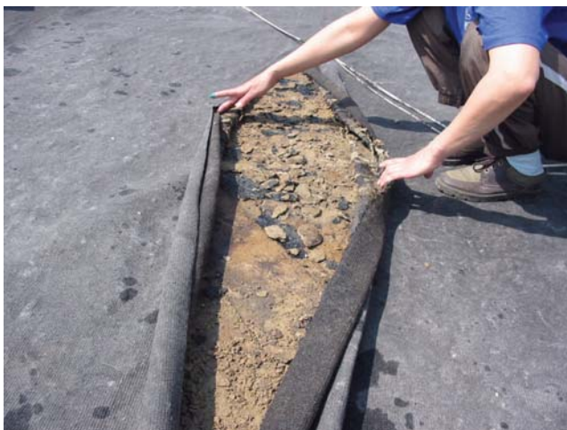
Obr. 1 Bytový dom Snina – plochá strecha rok po realizácii prespádovania a novej „hydroizolácie“ bola úplne nefunkčná
