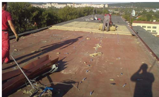
Obr. 6 Zásadné chyby pri realizácii rekonštrukcie plochej strechy boli dôvodom pre kompletnú demontáž strešného pláštia (novej hydroizolácie a tepelnej izolácie). Nutnosť potvrdil to aj súdnoznalecký posudok
