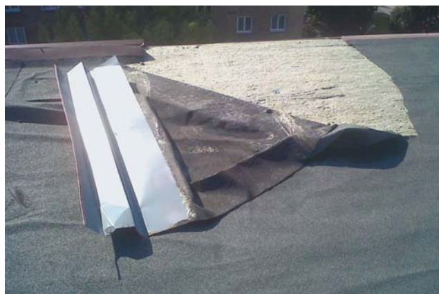
Obr. 5 Bytový dom Košice – stav strechy pol roka po realizácii rekonštrukcie plochej strechy so zateplením. Vplyvom vetra odtrhnuté oplechovanie okraja strechy aj s časťou hydroizolácie
