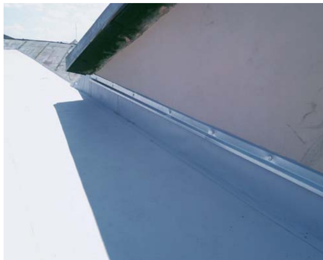
Ukončenie PVC fólie na zvislej stene – priame kotvenie pomocou poplastovaného pásika, celý detail je prekrytý lištou z pozinkovaného plechu s pretmelovaním v styku s omietkou
