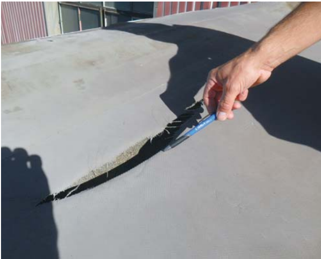
Výsledok nesprávneho kotvenia a chýbajúcej separácie medzi oxidovanými asfaltovými pásmi a PVC fóliou – strata mechanických vlastností PVC fólie sa prejavila popraskaním a roztrhnutím nosnej vložky
