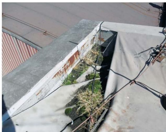
Okrem nevhodného kotvenia chýba aj separácia medzi pôvodnou krytinou z oxidovaných asfaltových pásov a novou PVC hydroizoláciou
