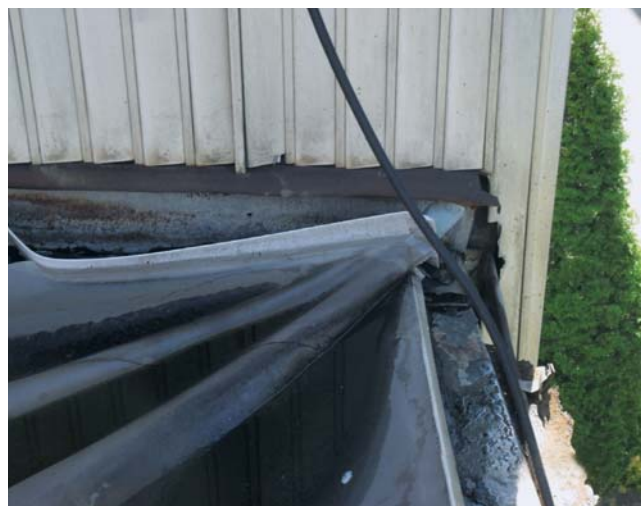
Rekonštrukcia plochej strechy realizovaná PVC fóliou – nedostatočné kotvenie na zvislej stene, PVC fóliu odtrhlo aj s kotviacim pásikom z poplastovaného plechu
